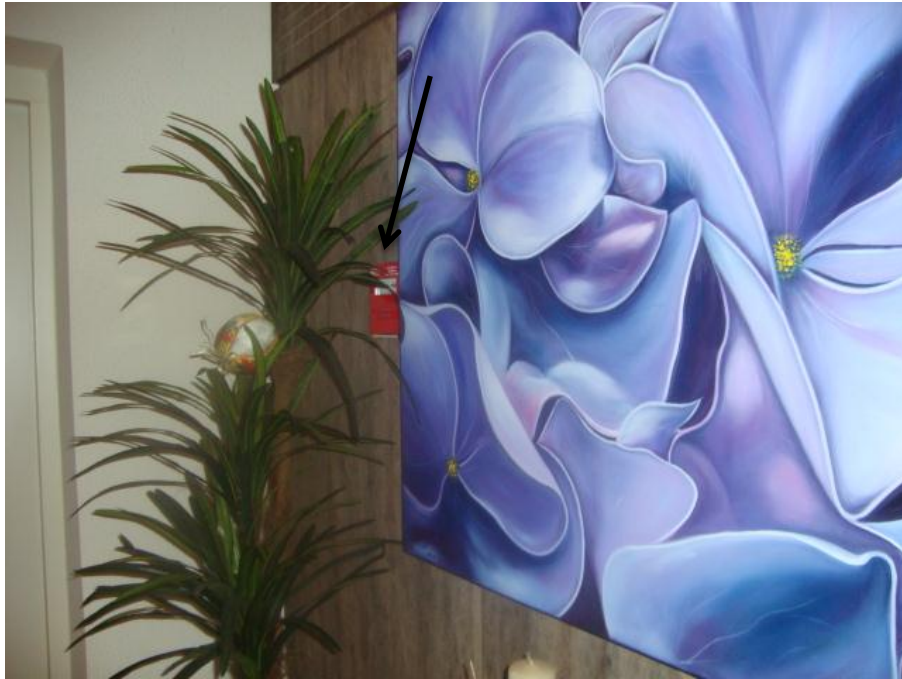
Acionador: alarme de incêndio
