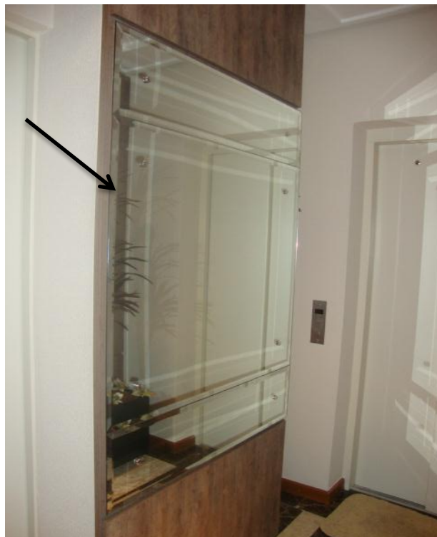
Caixa de hidrantes
