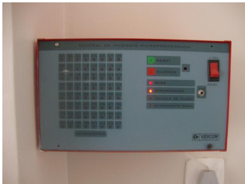
Central de alarme
