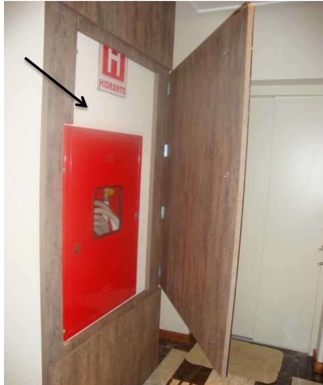
Caixa de hidrante: vista interna
