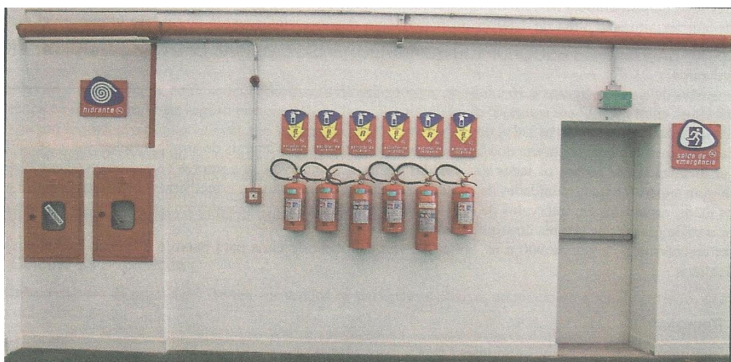
Figura 21: Equipamentos de proteção instalados no ginásio poliesportivo da PUCRS
