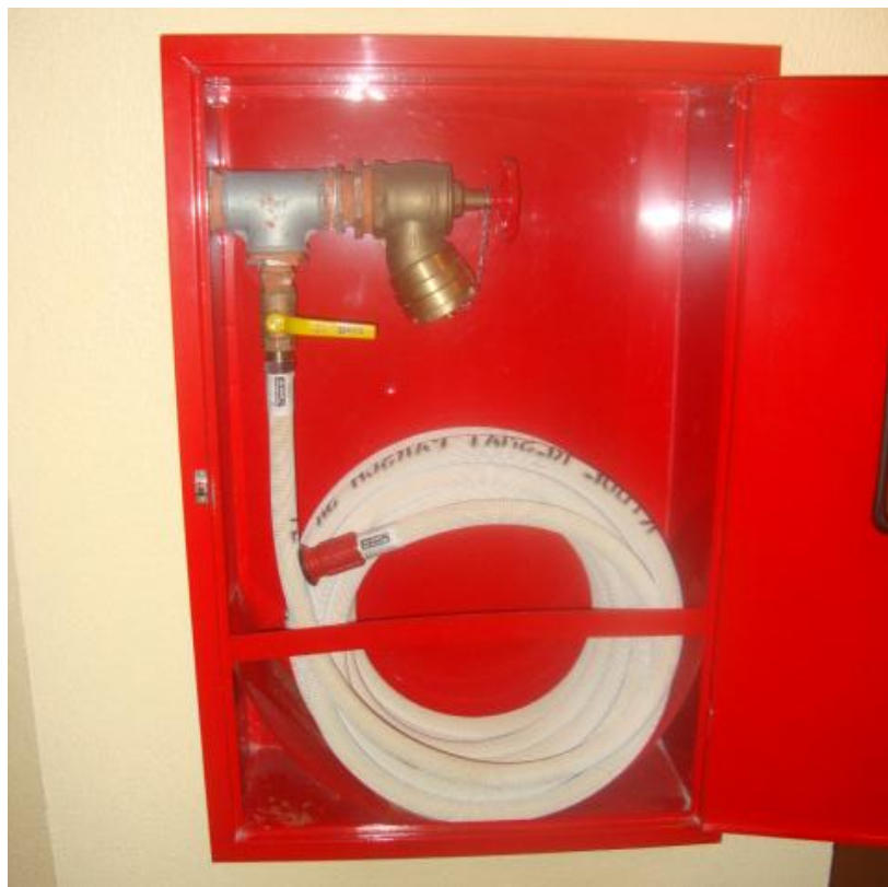
Vista interna: Hidrante
