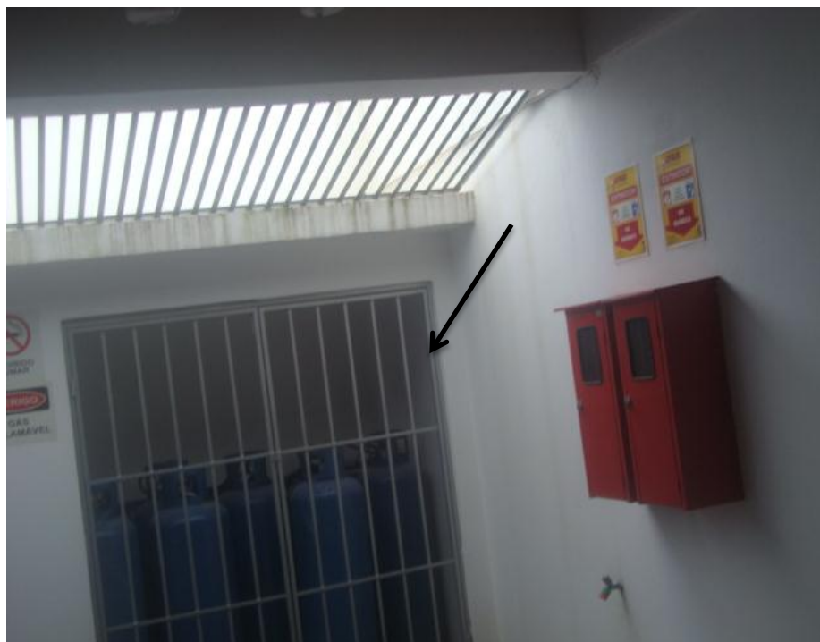
Central de gás
