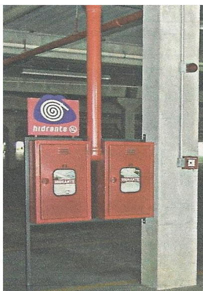
Figura 23: Hidrante: estacionamento PUCRS
