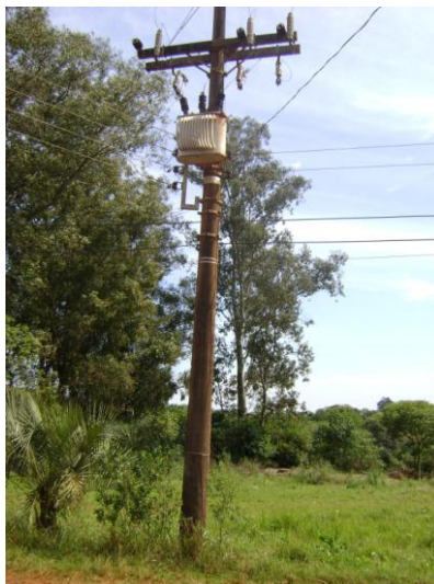
Figura 39: Energia elétrica próxima à região disponível Fonte: O autor (2010)
