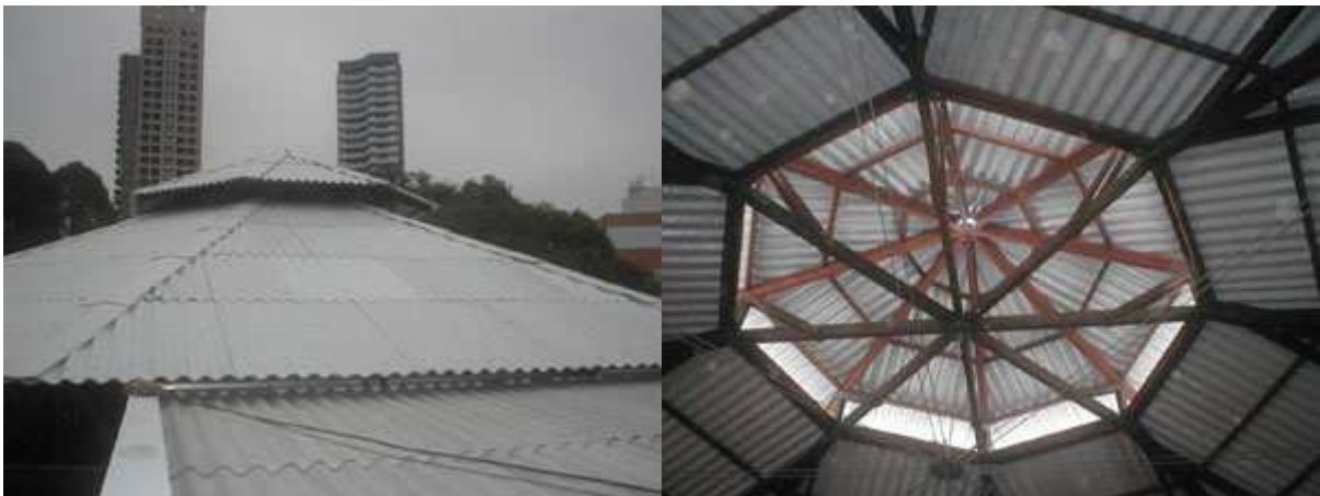
Figura13: Aplicação da telha de tubo de pasta de dentes na cobertura de uma escola.
