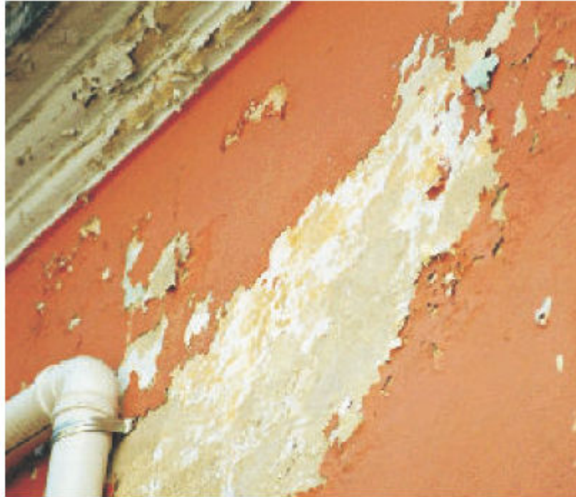
Figura 35: Descascamento da pintura. Fonte: http://www.clicnegocios.com .
