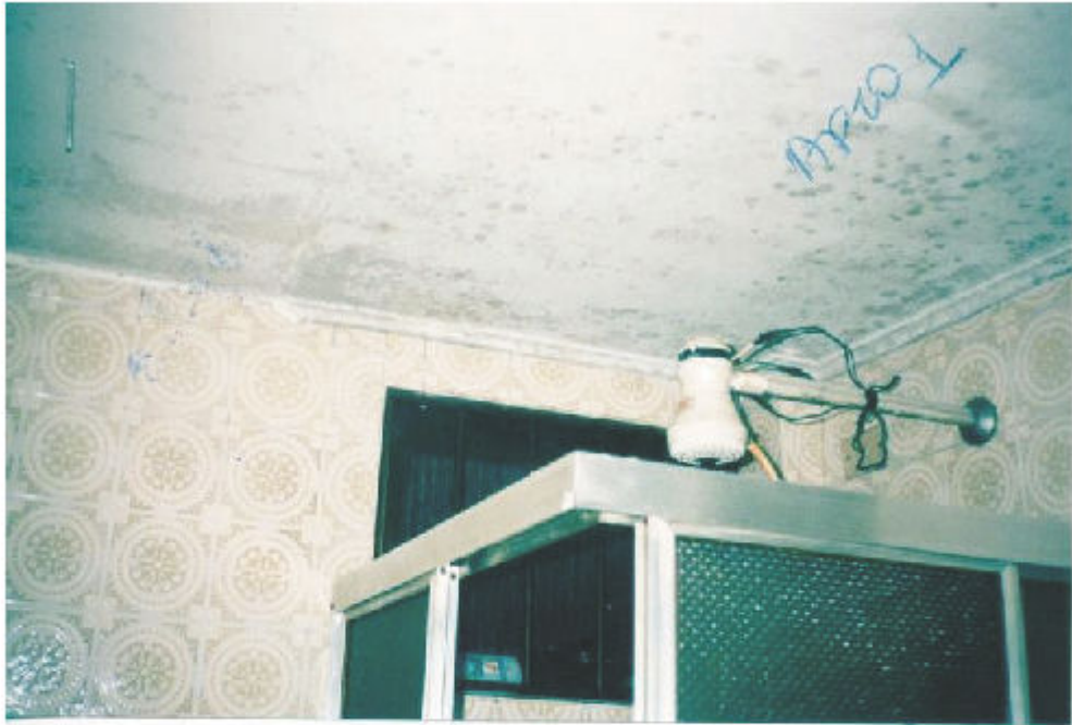
Figura 20: Condensação no forro do banheiro.
