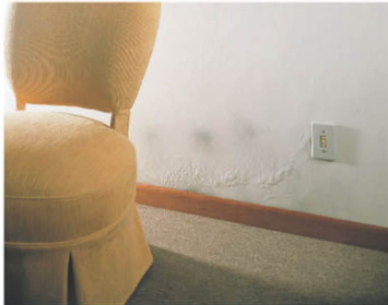
Figura 16: Mofo em alvenaria inferior. Fonte: http://www.mulherbeleza.com.br .
