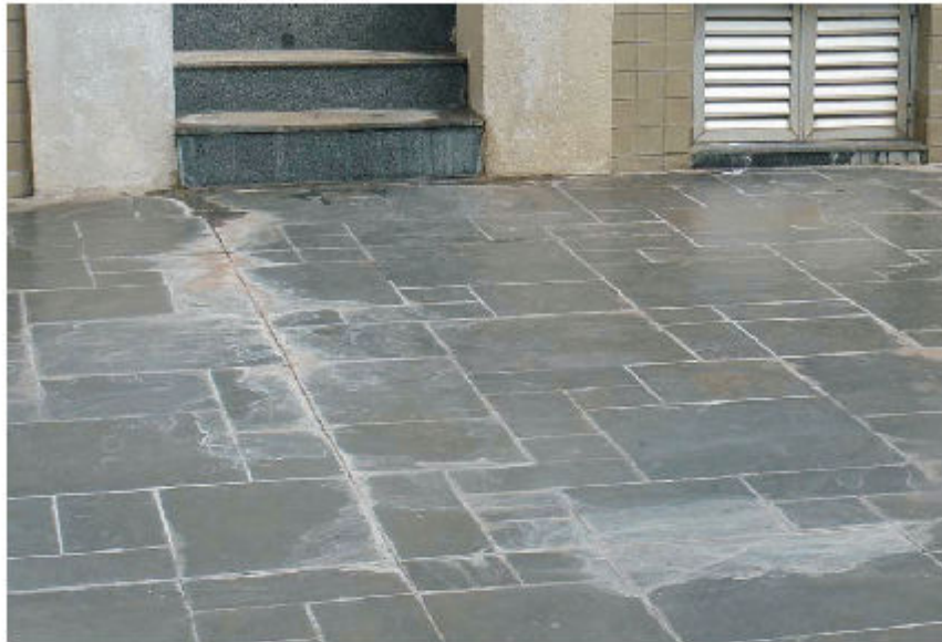
Figura 19: Formação esbranquiçada no piso. Fonte: Arquivo pessoal, 2009.
