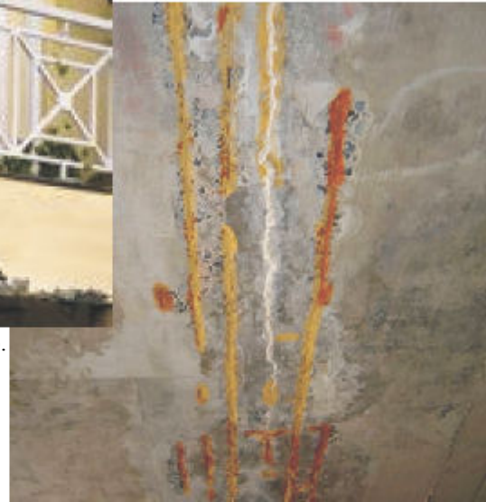
Figura 31: Corrosão de armaduras.
