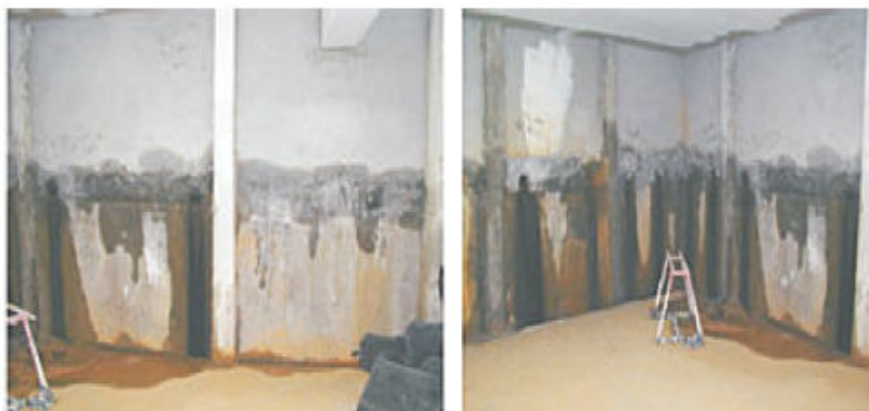
Figura 13: Percolação em alvenaria de garagem. Fonte: Arquivo pessoal, 2009.
