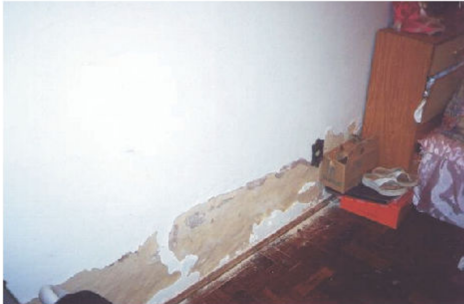
Figura 14: Percolação em alvenaria de garagem.
