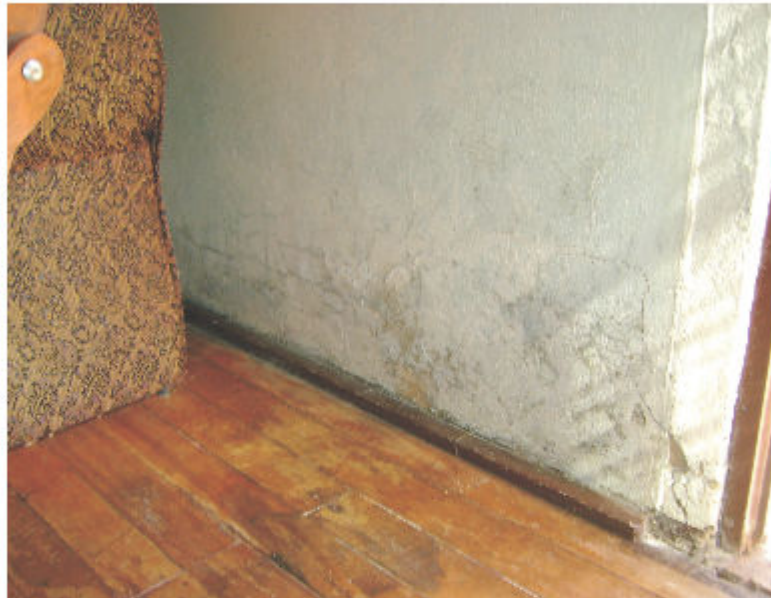
Figura 15: Manchas em alvenaria inferior por capilaridade. Fonte: Arquivo pessoal, 2009.
