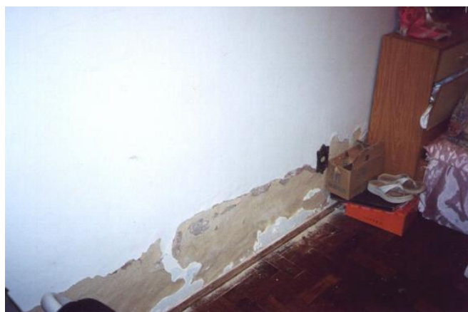
Figura 11: Desagregamento do reboco num dormitório. Fonte: Arquivo pessoal, 2009.
