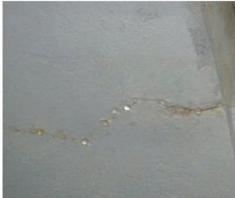
Figura 41: Goteira por trincas. Fonte: Arquivo pessoal, 2009.
