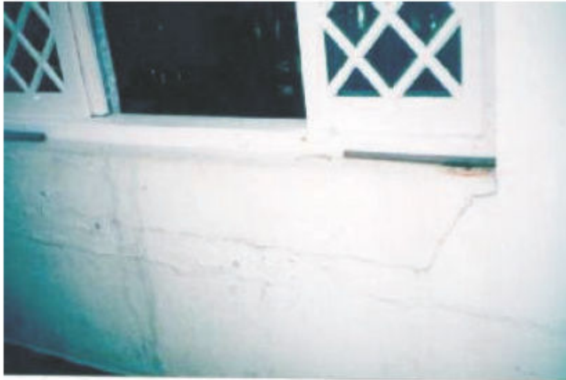
Figura 29: Manchas por percolação de água da chuva. Fonte: Fonte: http://www.ebanataw.com.br .
