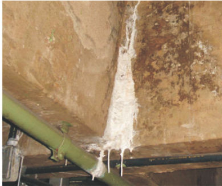
Figura 40: Eflorescência em encontro de vigas. Fonte: Arquivo pessoal, 2009.
