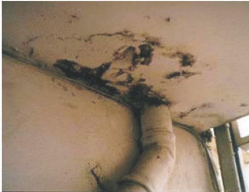
Figura 42: Mofo por ruptura de tubulação.
