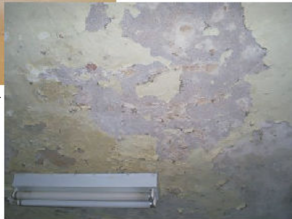
Figura 23: Descascamento da pintura do forro. Fonte: Arquivo pessoal, 2009.
