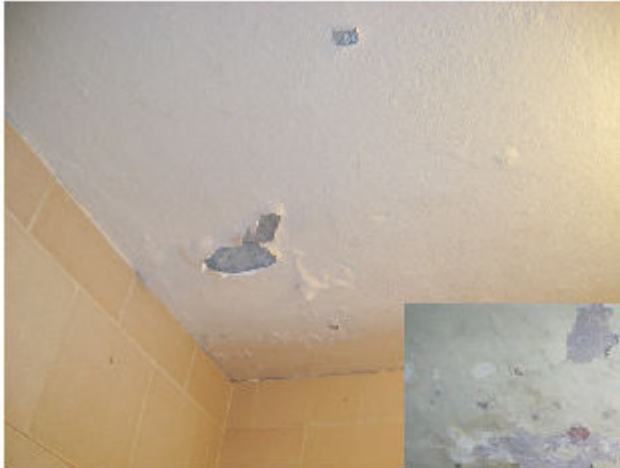
Figura 22: Embolhamento no forro. Fonte: Arquivo pessoal, 2009.
