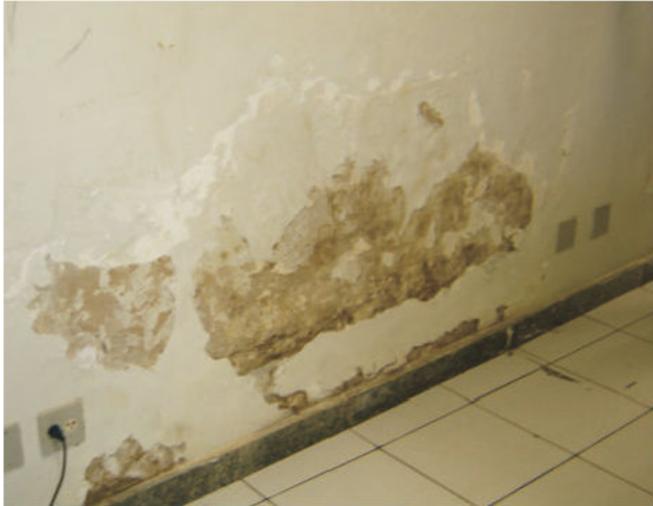
Figura 26: Manchas por ruptura de tubulação.
