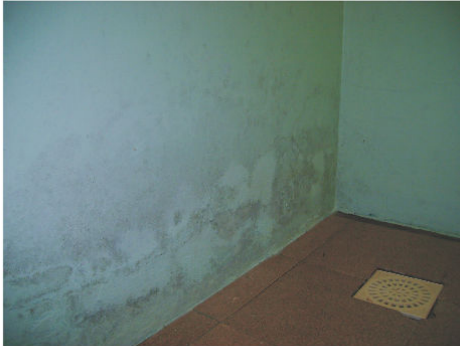
Figura 21: Manchas em alvenaria inferior por respingos. Fonte: Arquivo pessoal, 2009.
