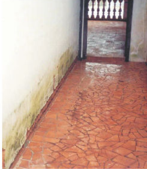
Figura 12: Formação de fungos por capilaridade. Fonte: Arquivo pessoal, 2009.
