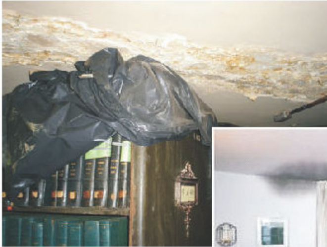
Figura 38: Mofo no forro.
