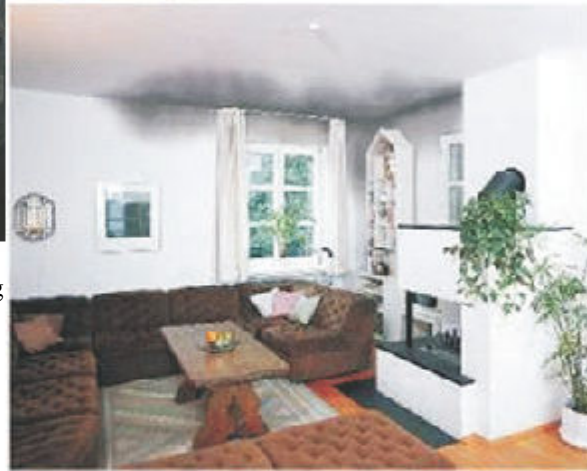
Figura 39: Mancha escura no forro.
