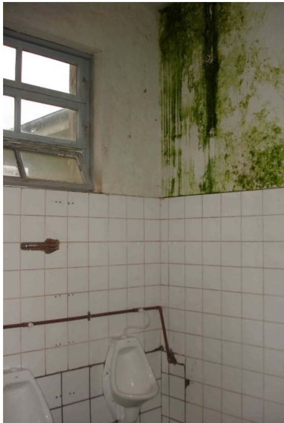
Figura 10: Fungos vegetais no banheiro. Fonte: Arquivo pessoal, 2009.
