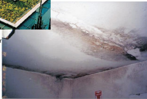
Figura 44: Manchas escuras no forro.
