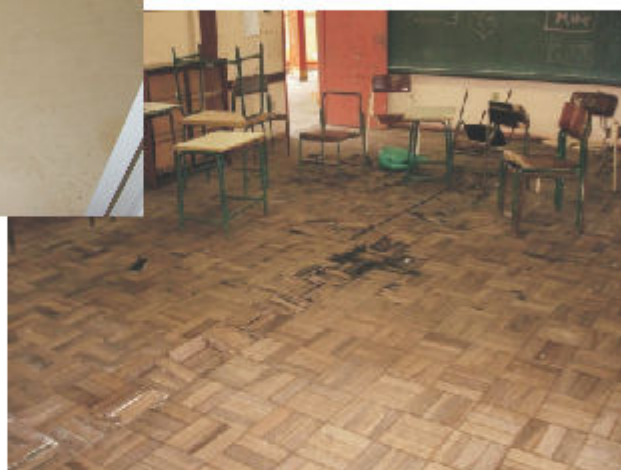
Figura 18: Manchas em parquet. Fonte: http://sfsonline.wordpress.com .
