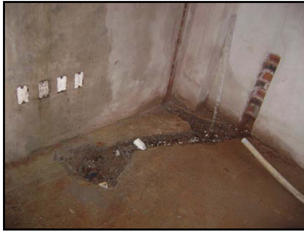
Figura 38: Quebra do contrapiso por execução errada – out/2009. Fonte: Autoria própria, 2009.
