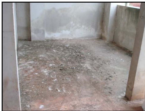
Figura 31: Concreto do piso deteriorado pela ação da umidade – ou/2009. Fonte: Aatoria própria, 2009.
