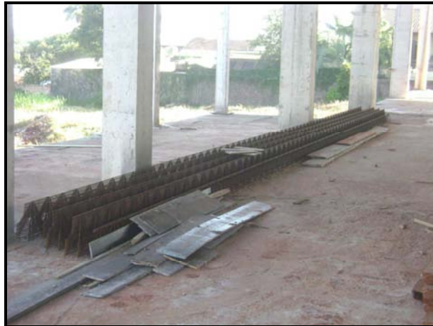
Figura 26: Imagem do local de armazenamento das treliças – mai/2009. Fonte: Autoria própria, 2009.
