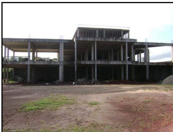
Figura 29: Estruturas de concreto armado do pavimento subsolo e térreo – out/2009. Fonte: Aatoria própria, 2009.
