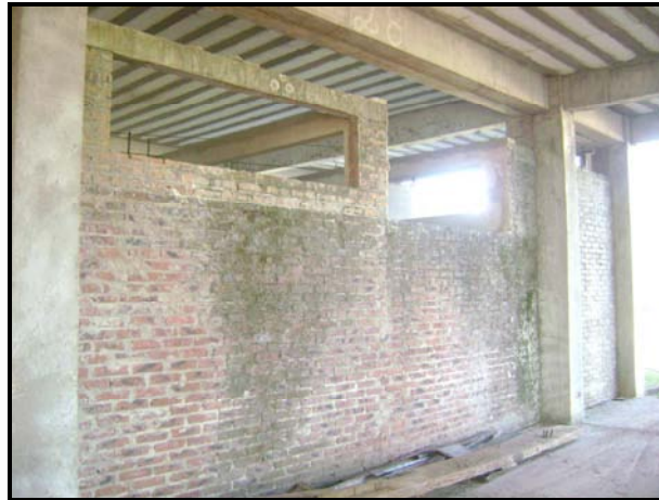
Figura 30: Parede localizada no térreo, danificada pela ação da umidade – mai/2009. Fonte: Aatoria própria, 2009.
