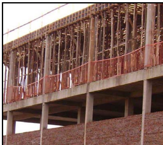
Figura 21: Imagem da sinalização de segurança contra altura, no 3º pavimento – set/2009. Fonte: Autoria própria, 2009.
