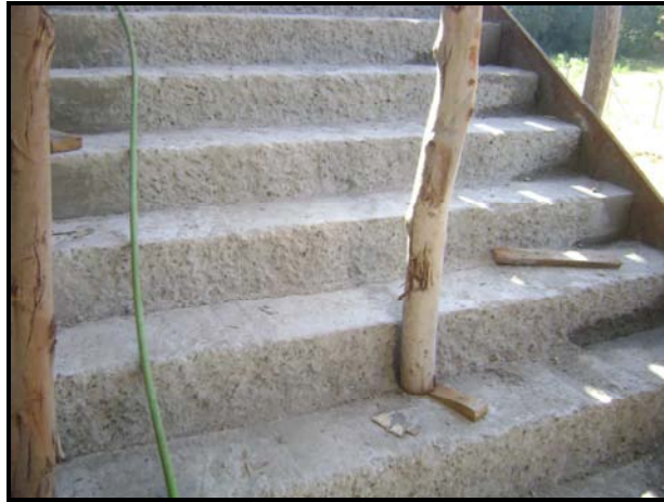
Figura 41: Correção do defeito na escadaria – mai/2009. Fonte: Autoria própria, 2009.
