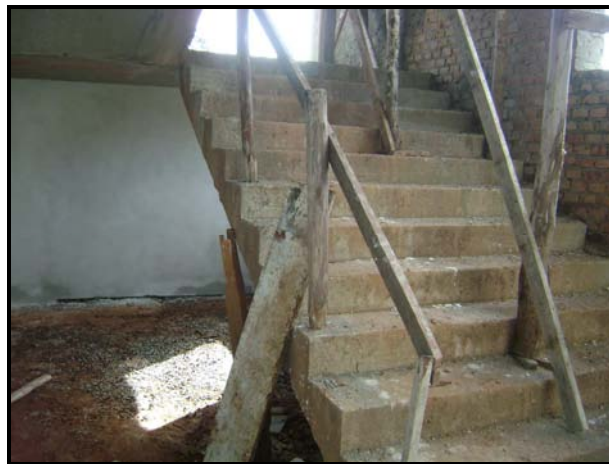
Figura 20: Proteção coletiva apresentada com corrimão nas escadarias – jun/2009. Fonte: Autoria própria, 2009.
