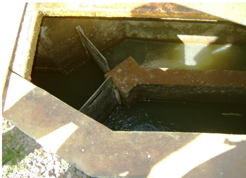
Figura 19: Sistema de Desarenação.
