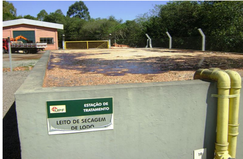
Figura 29: Leito de Secagem de Lodo.
