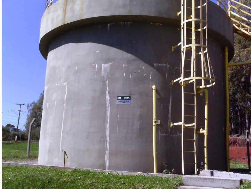
Figura 22: Reator Anaeróbio do tipo UASB.
