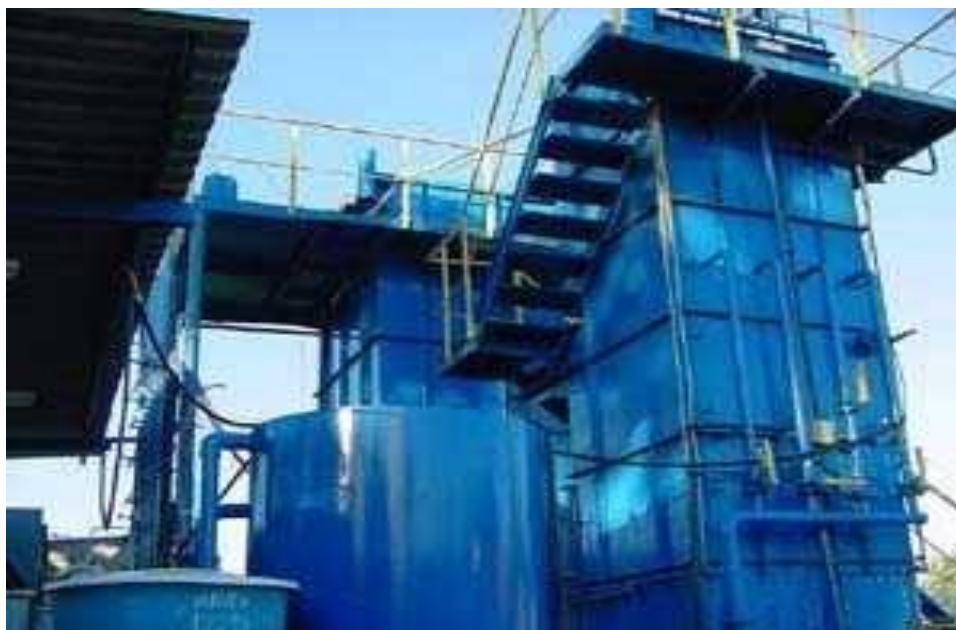
Figura 05: Estação de tratamento da UFES.
