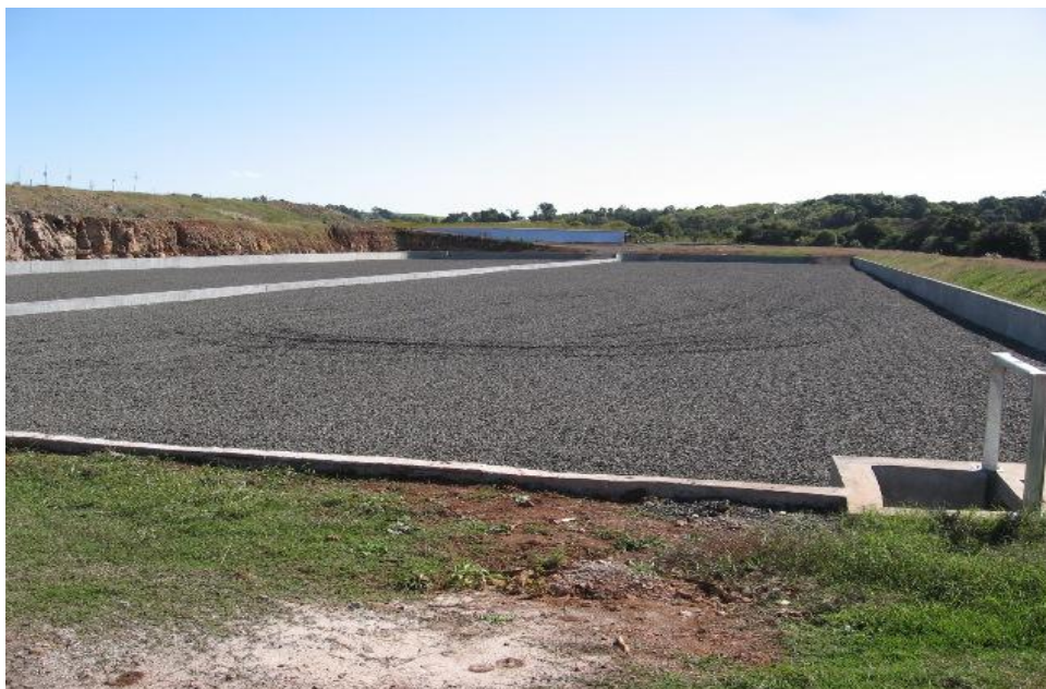
Figura 02: Banhado construído na ETE Convencional- Ijuí/RS.
