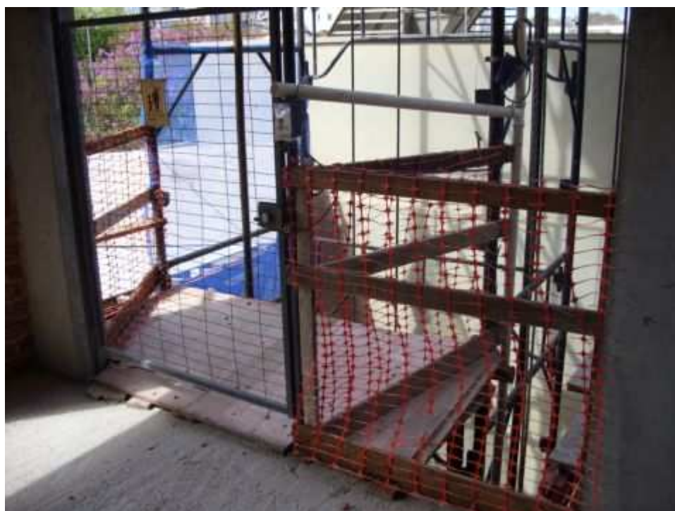
Figura 4: Portão eletrônico do elevador de materiais.
