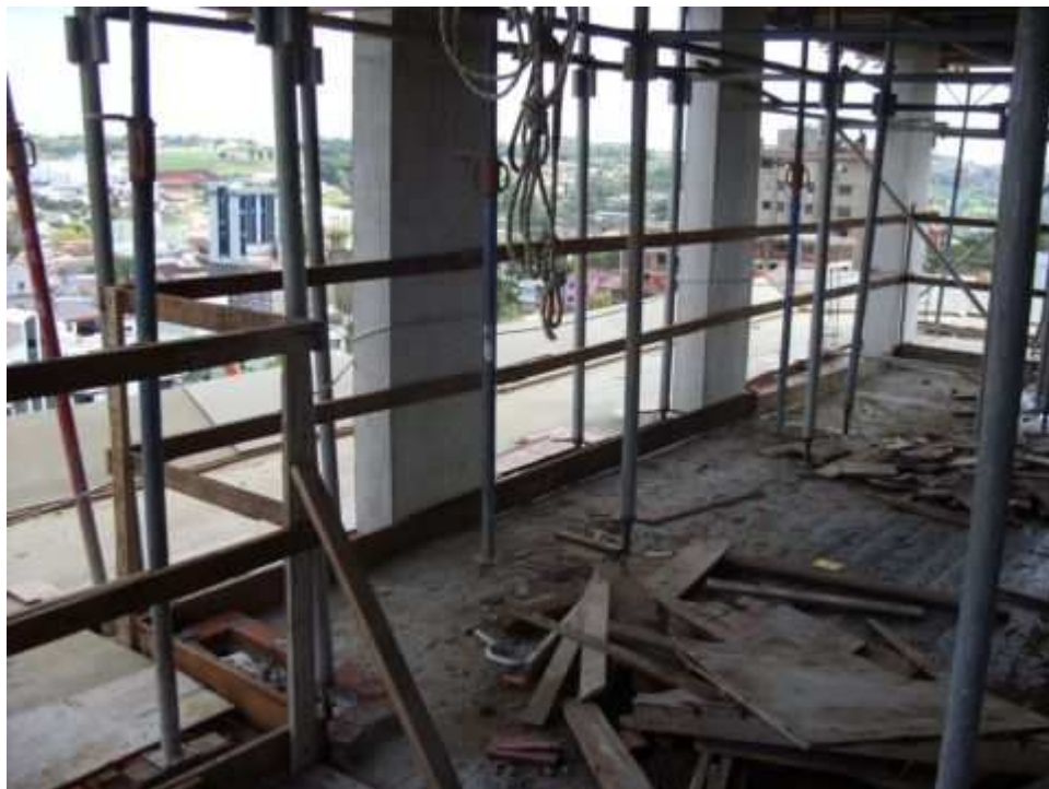
Figura 7: Guarda-corpo no perímetro do prédio, sem a tela de proteção.
