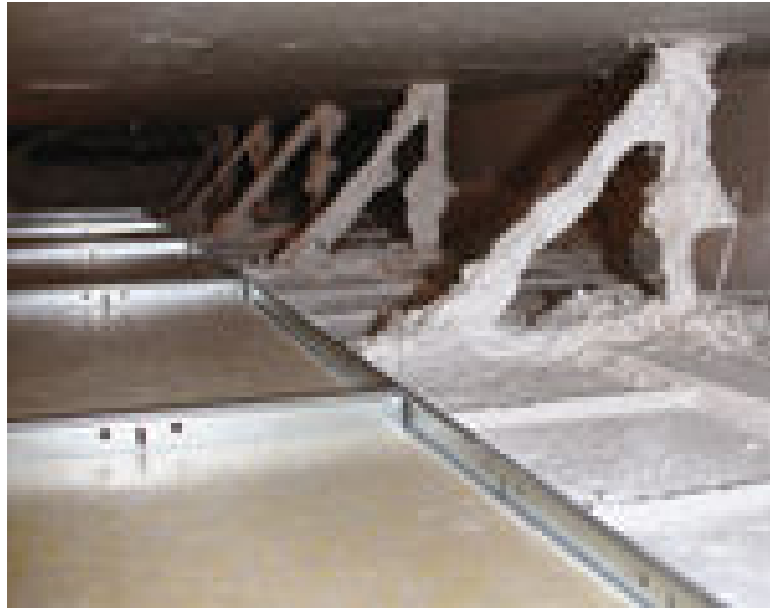
Figura 23: Forro de lã mineral com recobrimento nos pendurais.
