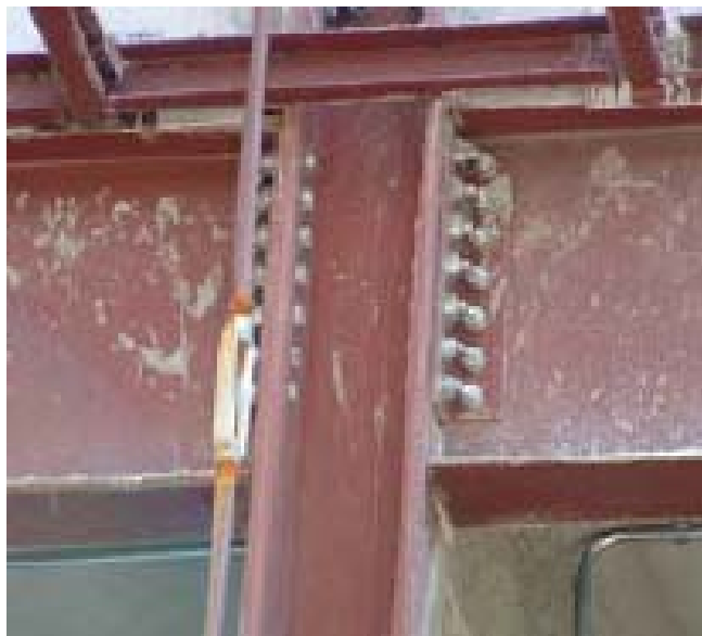
Figura 11 – Ligação parafusada (viga / pilar) Fonte: CBCA (2007)
