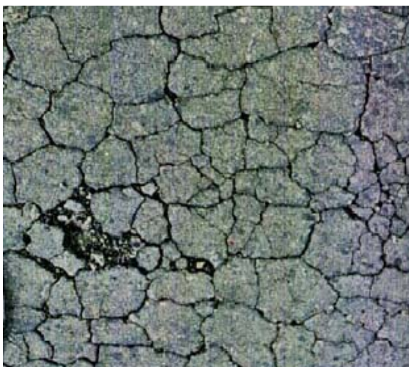
Figura 7: Trincamento por fadiga
