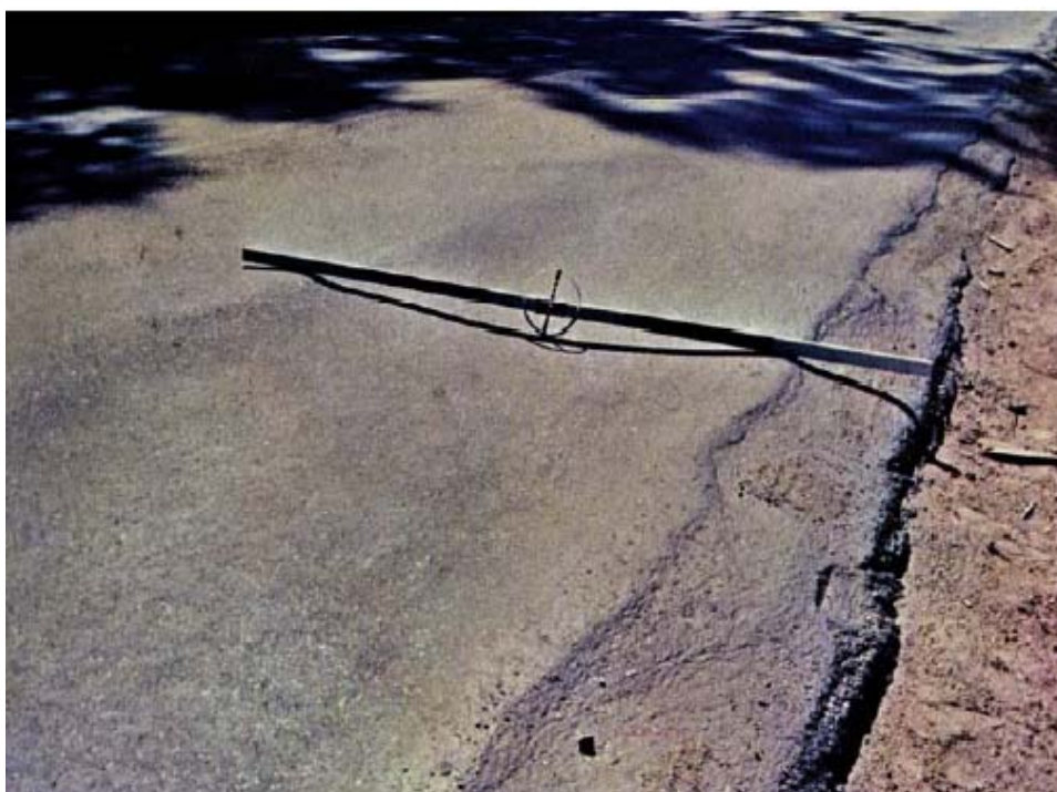
Figura 6: Deformação permanente ou afundamento de trilha de roda
