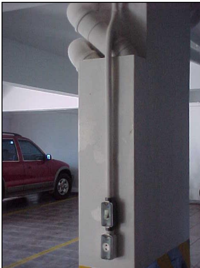
Figura 24: Vista do tubo de PVC para esgoto no Edifício São Paulo no subsolo
