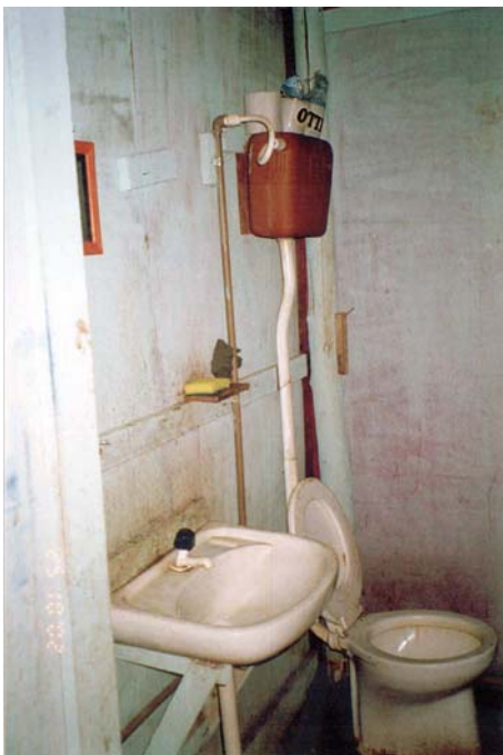
Figura 4: Sanitário e lavatório, obra 1
