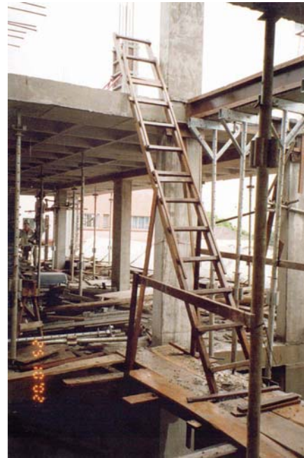
Figura 6: Escada de mão, obra 1
