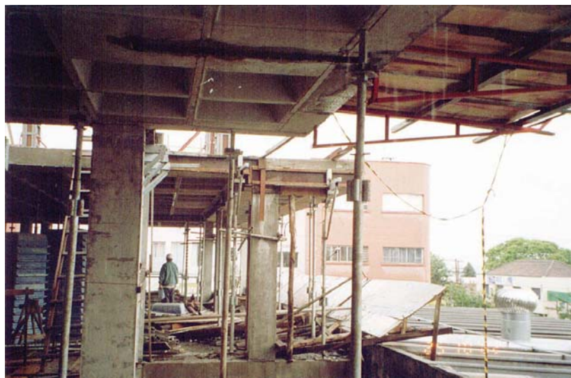
Figura 3: Vista inferior das bandejas de proteção da obra 1
