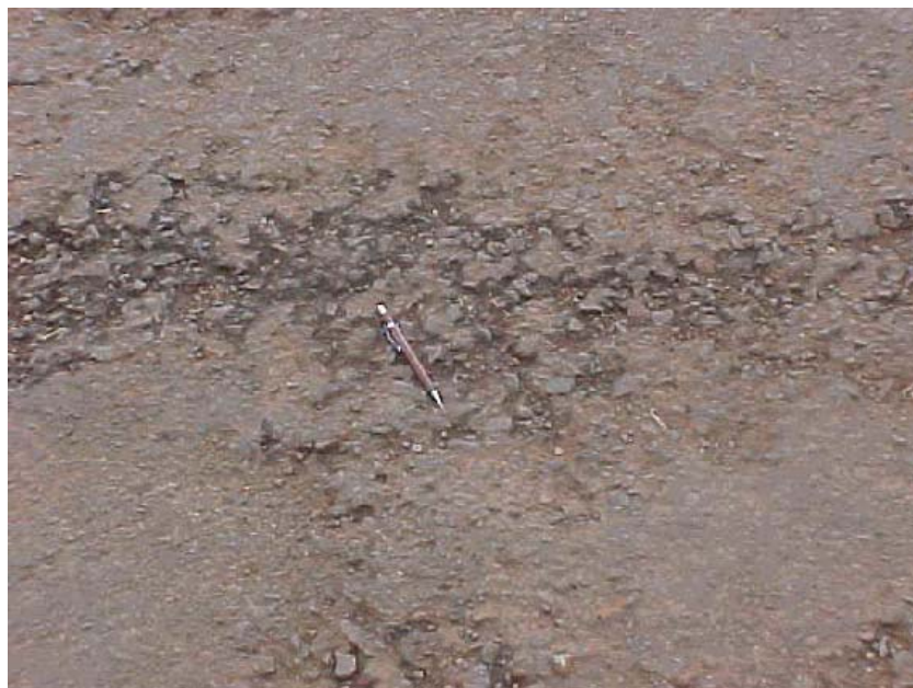
Figura 2.1: Defeito provocado por falta de adesividade; entroncamento da Rua do Comércio com RS - 342, próximo ao Campus da UNIJUÍ.
