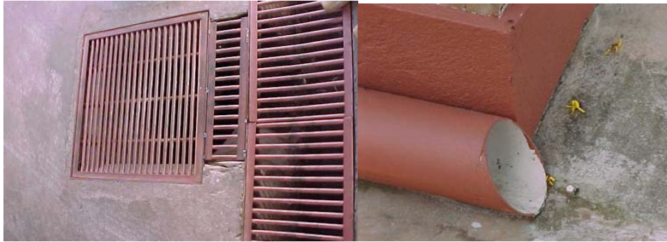
Figura 13: Vista de uma grelha de água pluvial e de um condutor de água Pluvial (destino rede pública)
