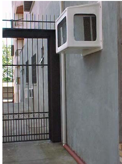
Figura 14: Vista de um coletor vertical de água pluvial
