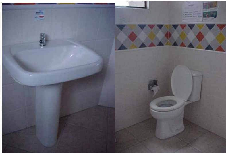
Figura 12: Vista da torneira de pressão e da caixa de descarga econômica, na clínica médica.
