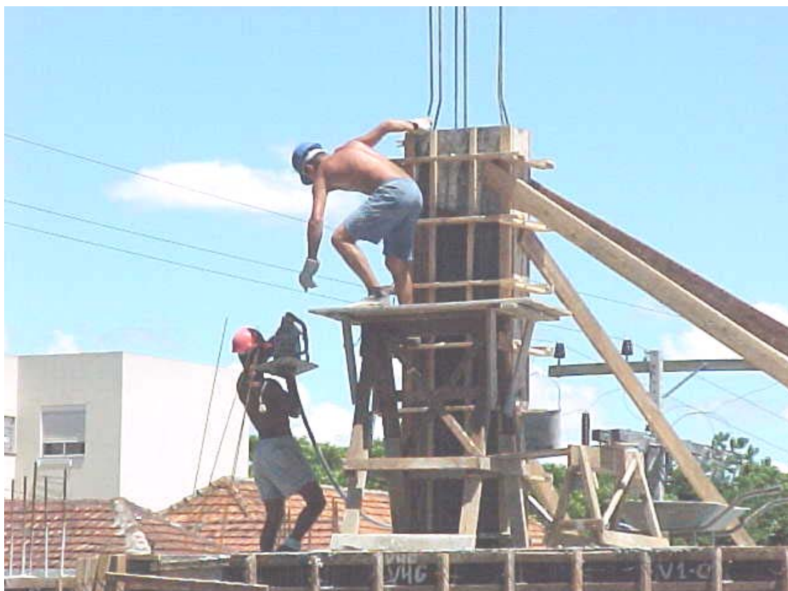
Figura 7: Trabalhadores sem o uso do cinto de segurança
