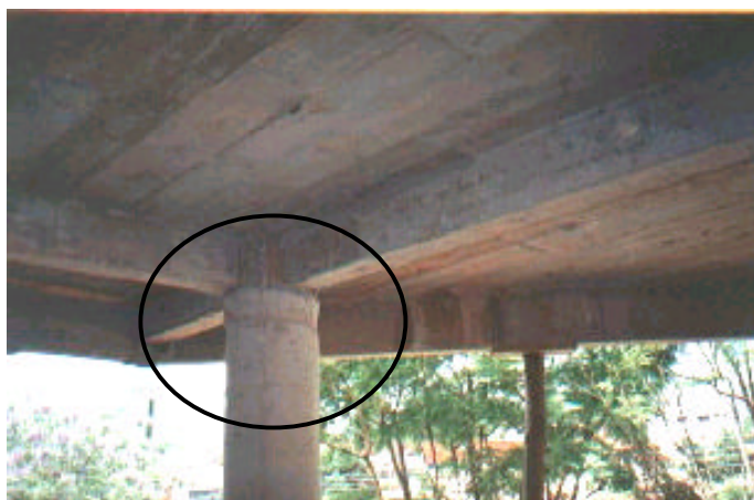
Figura 24 – Defeito na forma de pilar com seção circular
