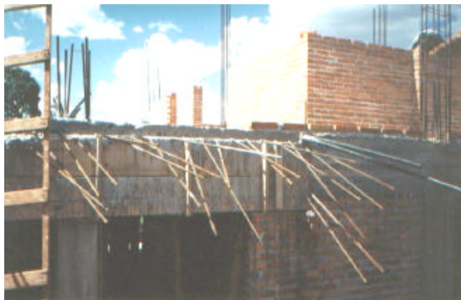
Figura 15 – Utilização de aço 12,5 mm no lugar de 10 mm
