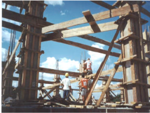
Figura 30 – Plataforma inadequada de trabalho
