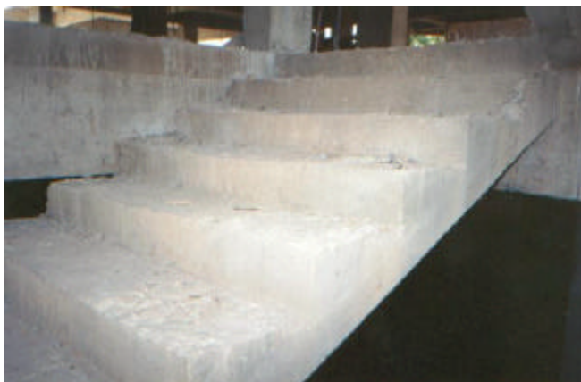
Figura 27 – Falta de acabamento nos patamares da escada
