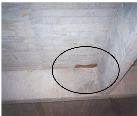
Figura 26 – Defeito na forma da laje
