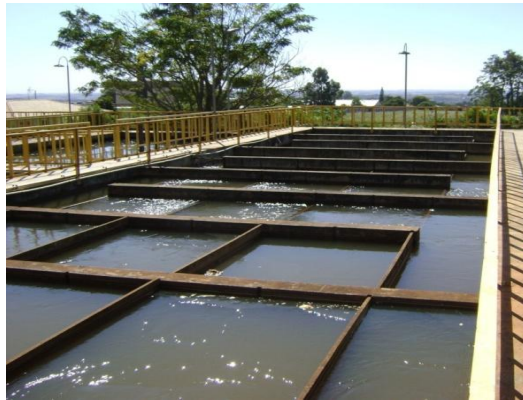
Figura 4- Tanque de floculação
