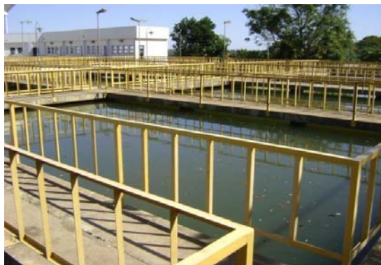
Figura 5- Tanque de decantação
